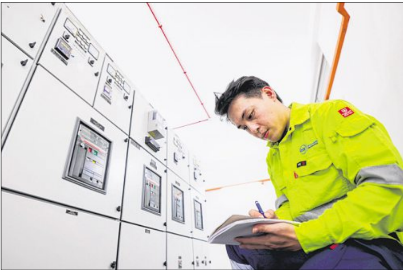
电气工程师许家兴到客户公司进行例行检查，按照清单逐项检视设备，确保电力设施安全运作。（林明顺摄）
